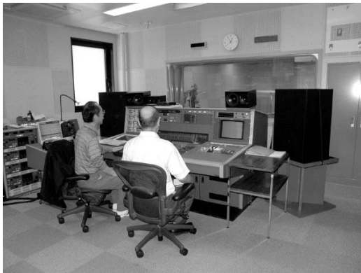
(写真3)ラジオ副調整室
